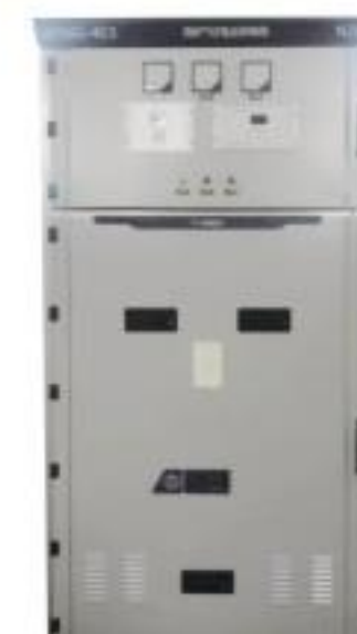
过电压抑制柜
