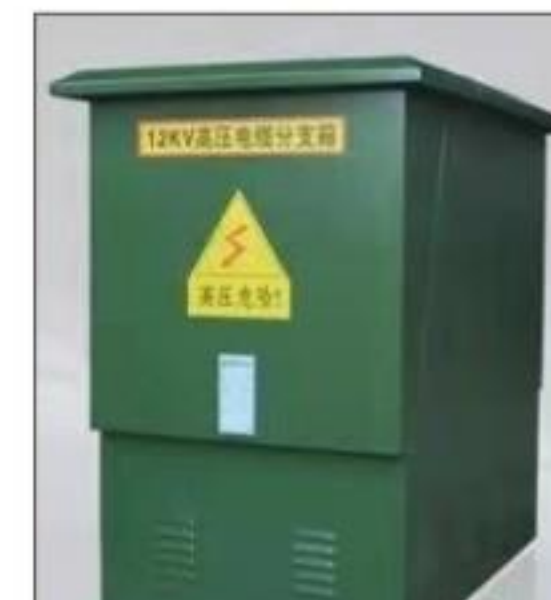
12KV电缆分支箱
